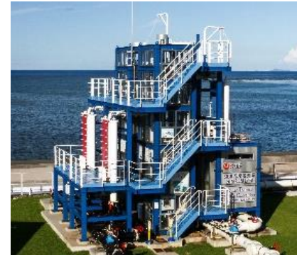
OTEC Demonstration Facility (Kumejima)
