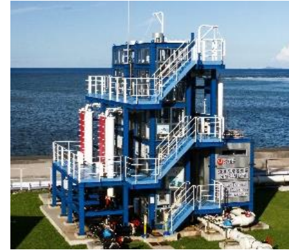
OTEC Demonstration Facility (Kumejima)
